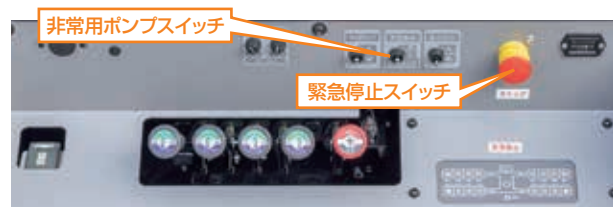
車両後端操作部
